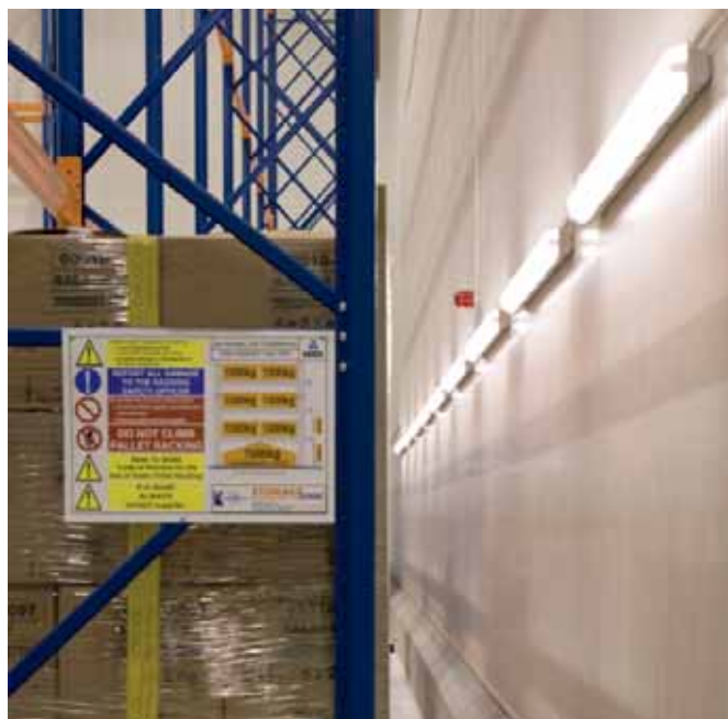
V sektoru mražených potravin musejí být potraviny skladovány při teplotách pod bodem mrazu. Logickým řešením jsou svítidla ColdForce, která fungují až do -30 °C.
